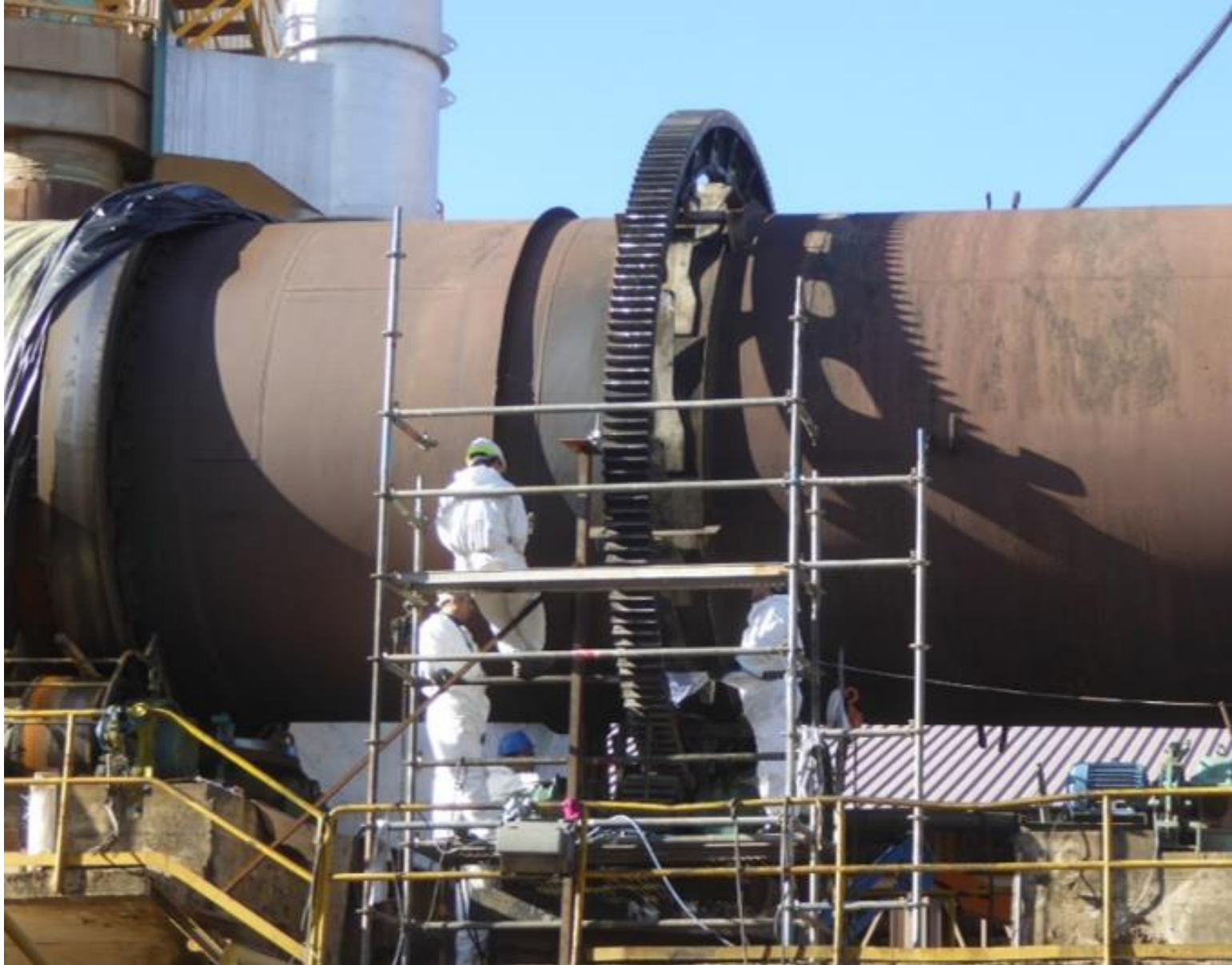
Bernardo F. de Mendonça, Paulo M.S.T. de Castro, 'Rupture of the girth gear / kiln shell connection at an expanded clay factory', Anales de Mecánica de la Fractura , 2020
